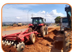
RECURSO PARA PAVIMENTAÇÃO DA DF-440 (PRÓXIMA AO RK E ESCOLA SANTA HELENA)
